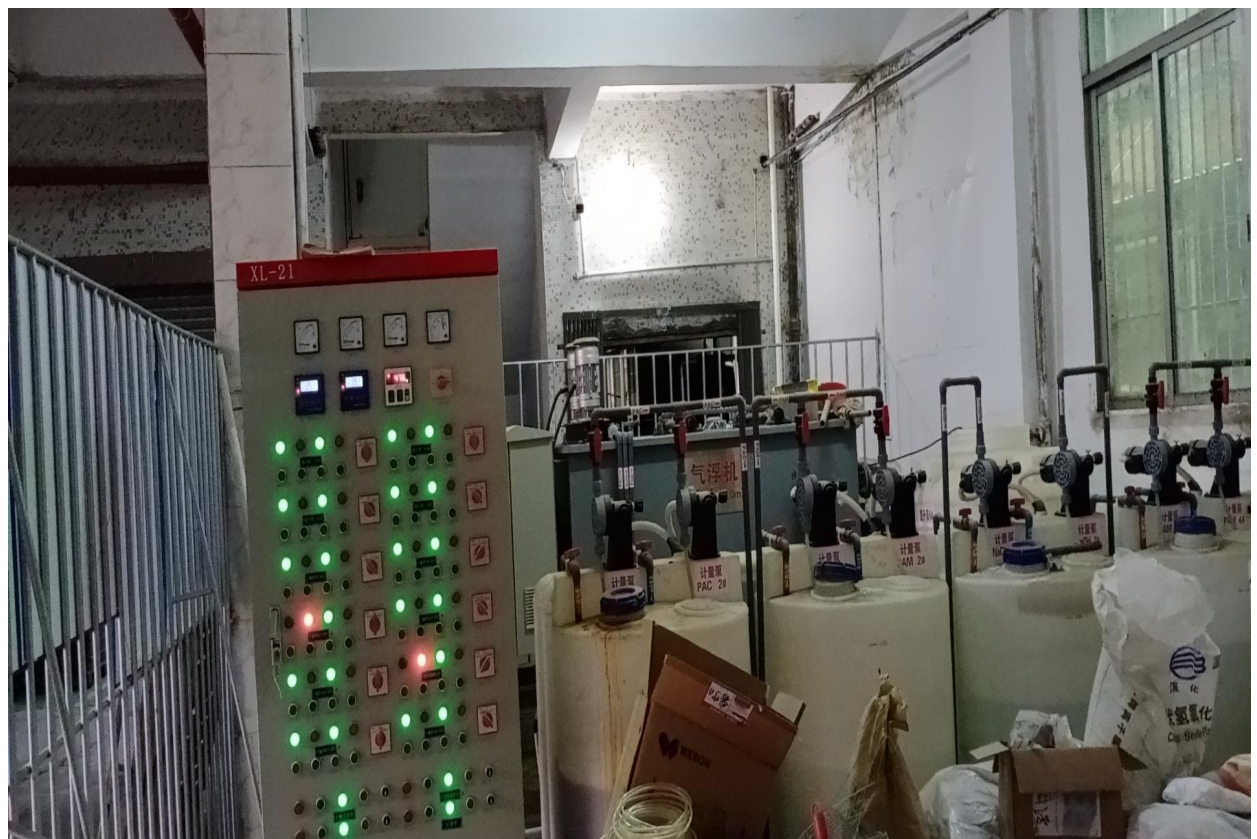
废水处理设施
