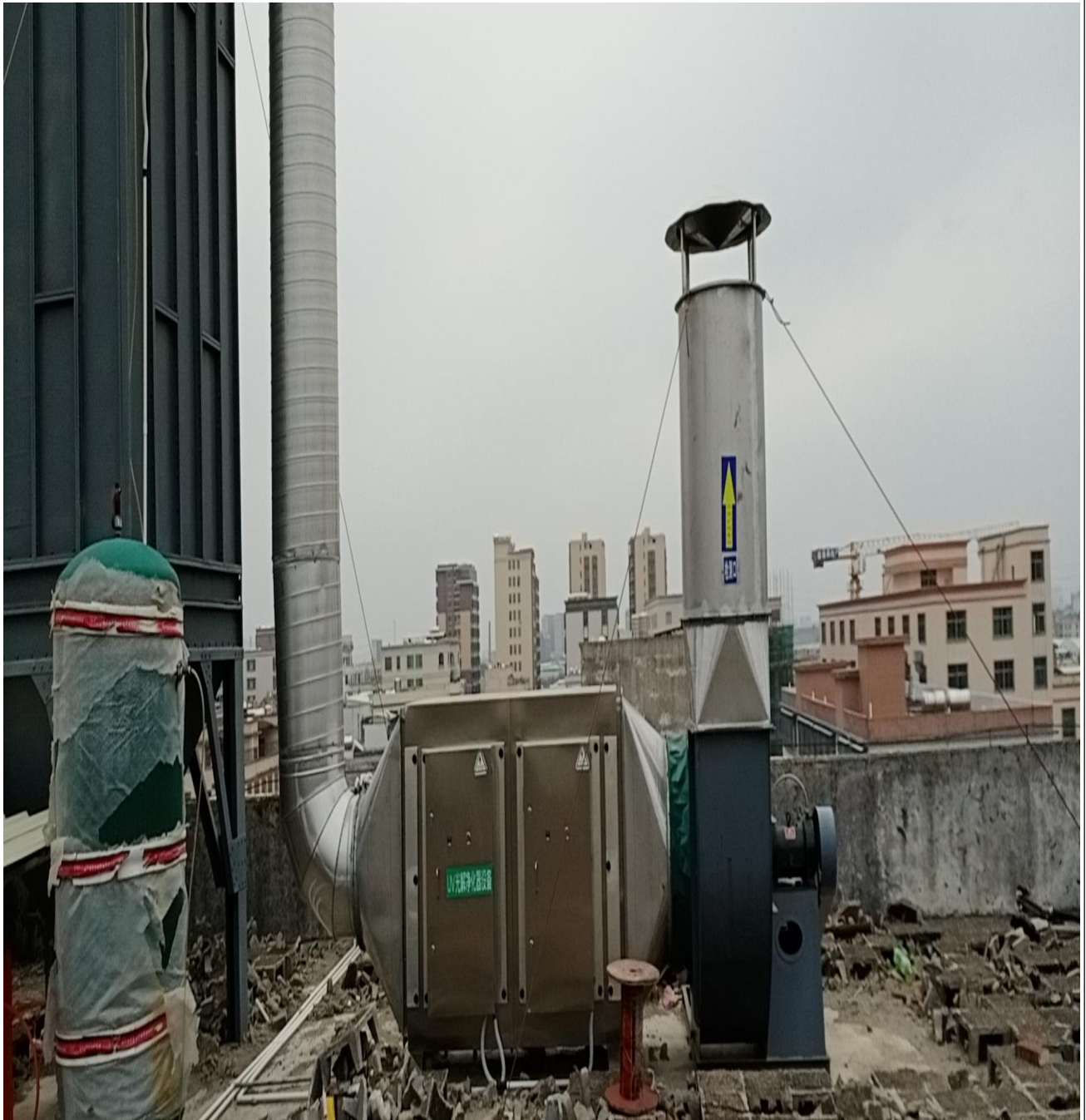
布袋除尘设施+ UV 光解处理设施
